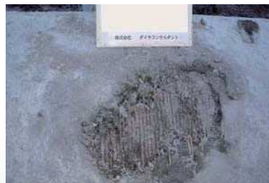
劣化状況の例
