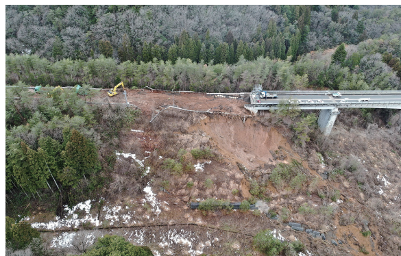
写真-1 のと里山海道の盛土被害
