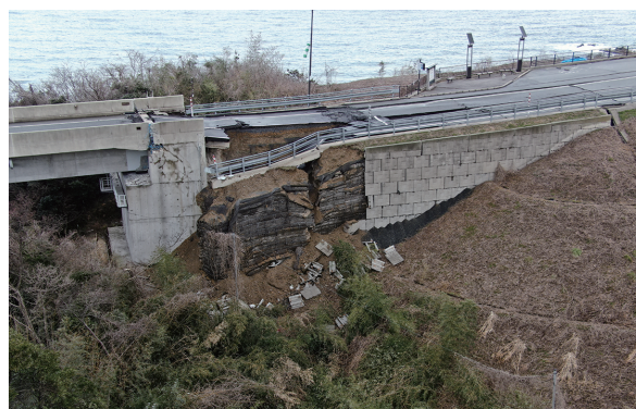
写真-2 国道249号の橋梁被害
