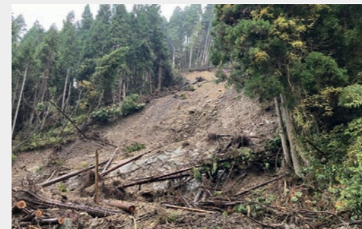
能登半島地震と豪雨災害で二度被災した道路のり面
