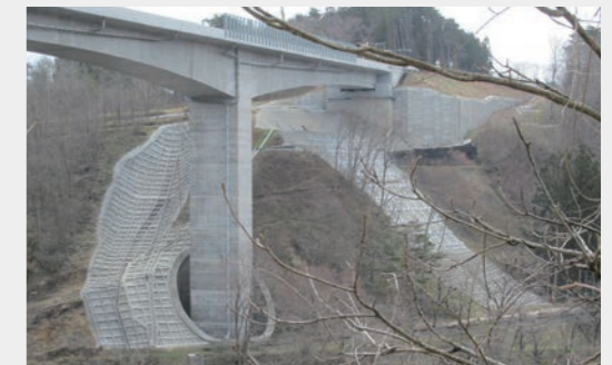
東日本大震災で被災した斜面の復旧対策設計(橋台取付部ののり面対策)
