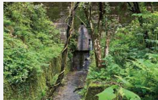
能登半島地震で破損した砂防堰堤
